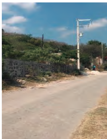
COL. ANTONIO RIVAPALACIO (LAS CARPAS) AMPLIACIÓN DE RED DE DISTRIBUCIÓN ELÉCTRICA EN LA CALLE 12 DE OCTUBRE
