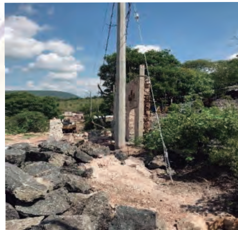
COL. PALO GRANDE AMPLIACIÓN DE RED DE DISTRIBUCIÓN ELÉCTRICA EN LA CALLE BUGAMBILIAS
